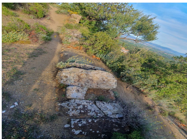
Photo1 : Dégradation du mur Ujahli à cause des alias climatiques (vent, ...)
