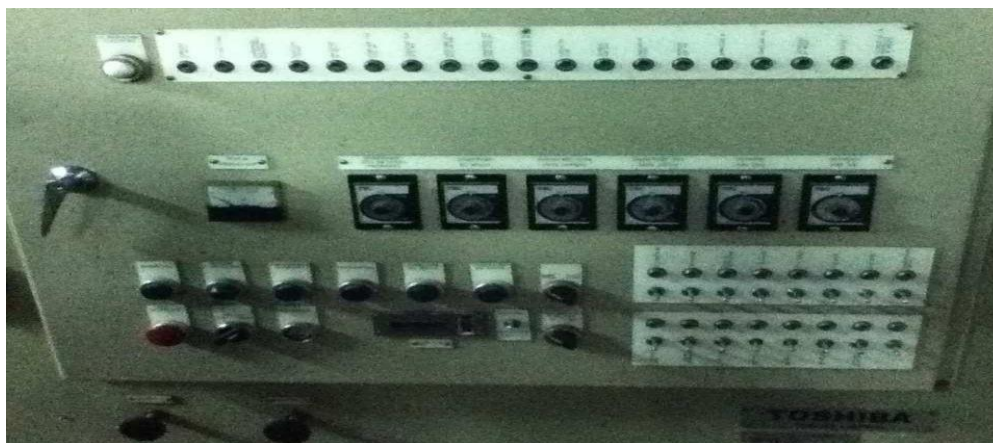
Figure II.7: Image photographique du tableau de commande.
