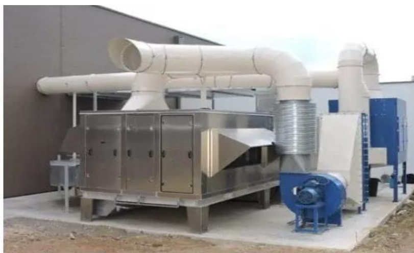
Figure I-13 : Centrale de traitement d'air
