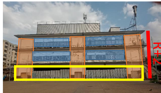
Figure 89: facade de bâtiment d'ancienne gare, style moderne, source : auteur, traité par auteur
