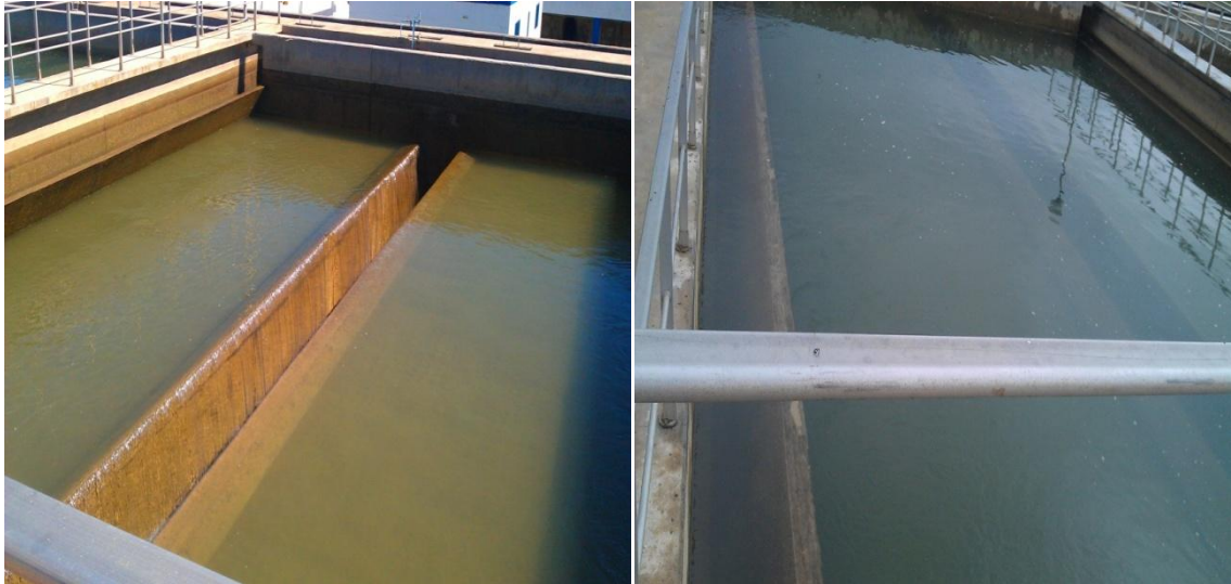
Figure 17 : Filtres à sable
