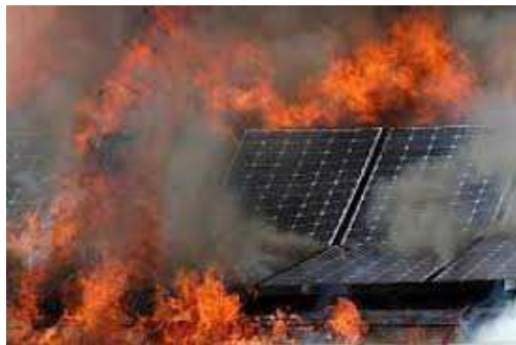
Figure III.4 : Effet de Hot Spot sur une installation PV.
