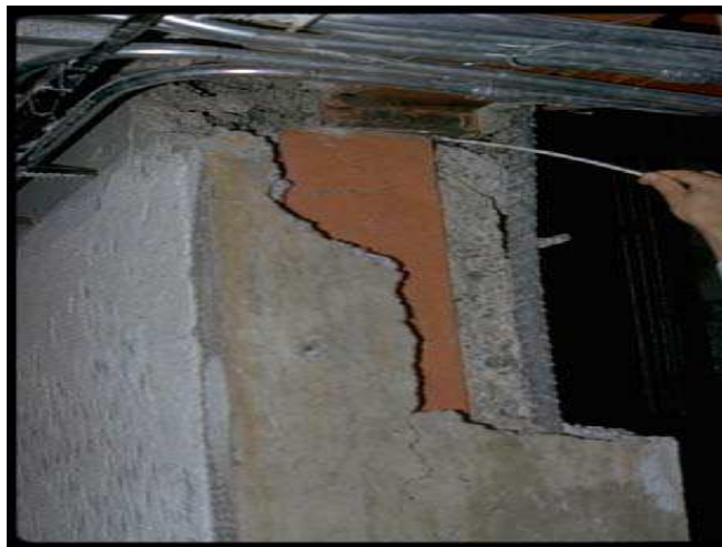
Figure II.15 Ossature acier enrobée de BA. Rupture par cisaillement sur soudure mal réalisée entre le poteau et la poutre. (Séisme d'Anchorage, 1964) (Document Karl-V. Steinbrugge)
