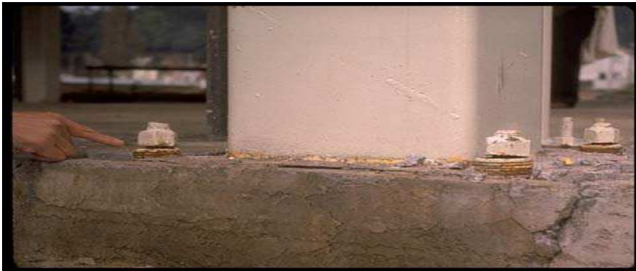
Figure II.16 Ossature acier enrobée de BA. Rupture par cisaillement sur soudure mal réalisée entre le poteau et la poutre. (Séisme d'Anchorage, 1964) (Document Karl-V. Steinbrugge)
