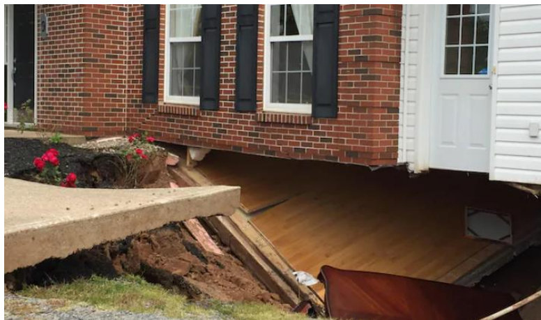
Figure 1.9. Affaissement causé par une faible capacité portante.
