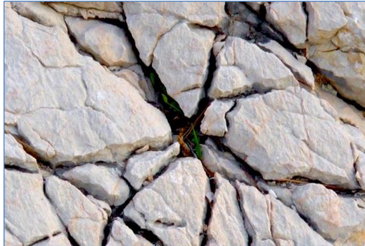
Figure 2.2. Altération de la roche.
