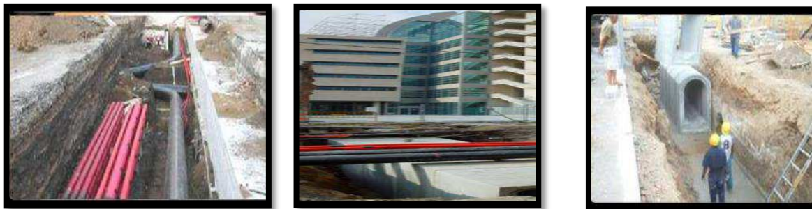
Fig33 : Réseaux d'énergies, de télécommunication, de climatisation centralisée et de recueil pneumatique.
