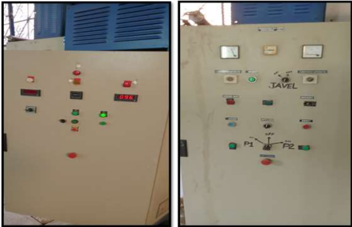
Photo n° 6 : les armoires électriques de station de Theboudh
