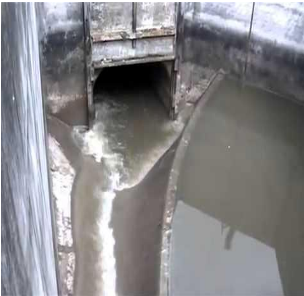
Figure I.12 : Un déversoir d'orage
