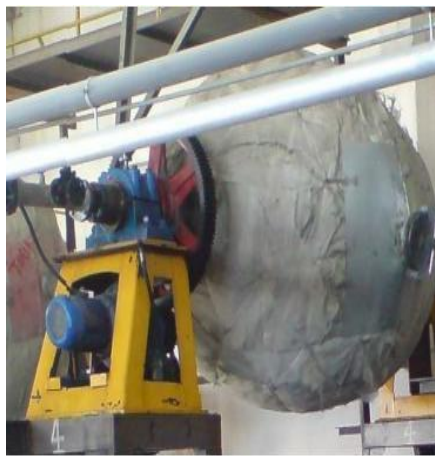
Figure II.15 : Tank où se déroule le séchage
