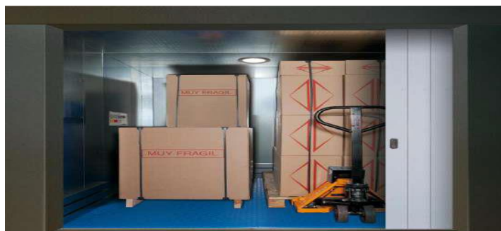
Figure I.1 : Ascenseur de charge
