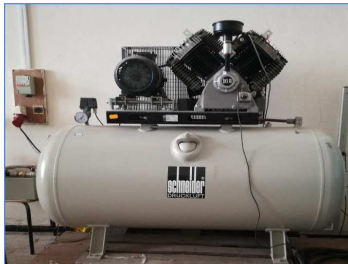
Figure (III.1): Vue générale du compresseur générateur de hautes pressions.
