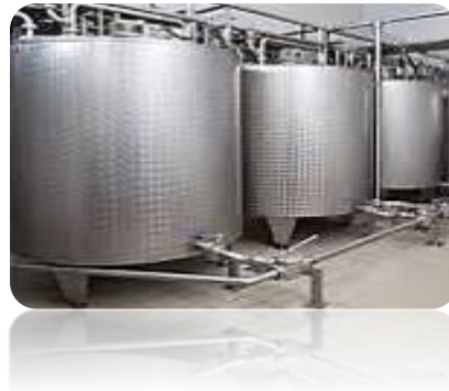
Figure 3.2 : Cuve de préparation, de transfert et stockage
