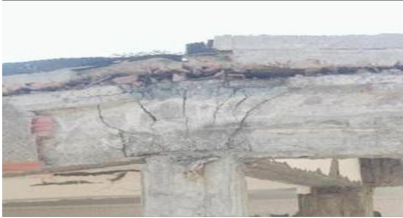
Figure I-5 : Rupture par cisaillement d'un nœud en béton armé
