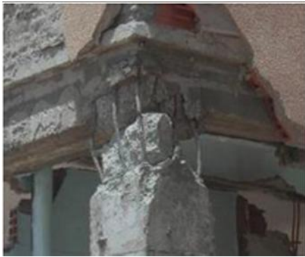
Manque d'étrier à l'assemblage poteau-poutre
