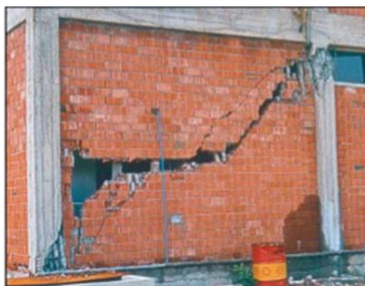
Figure I-15: Cisaillement des poteaux dus à l'interaction avec la maçonnerie (Adana – Ceyhan Turquie 1998) [27].
