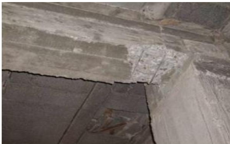
Figure I.4 : Fissuration par cisaillement dans la poutre
