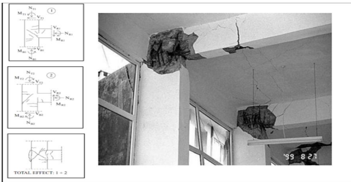
Figure I-19 : Type de dommage sismique des assemblages poteaux-poutres extérieure en T [27]
