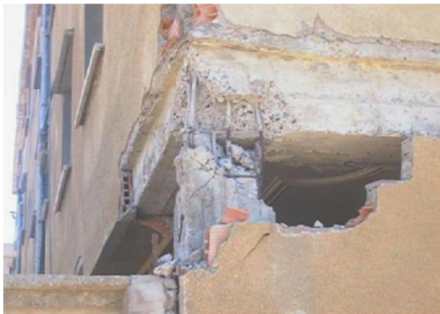
Figure I-17 : Ruine d'un nœud d'un poteau d'angle Bordj Elbahri
