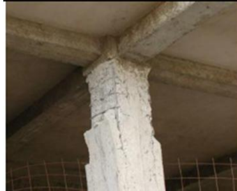
Ecaillage du béton à l'assemblage poteau- poutre
