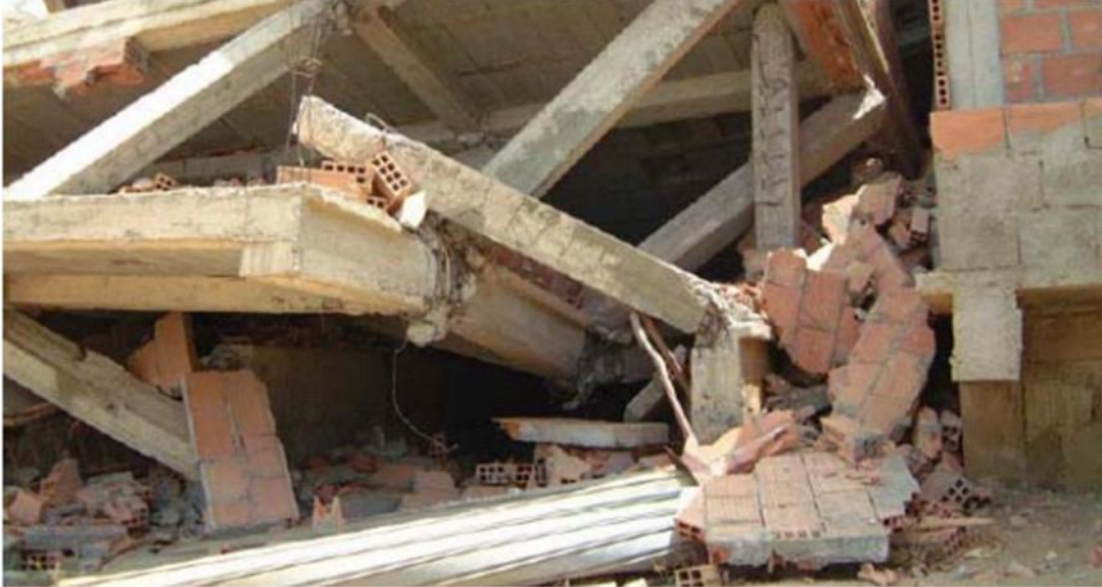
Figure I-10: Effondrement totale d'une ossature en béton armé
