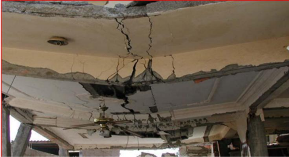
Figure I.1 : Fissuration par flexion dans la travée des poutres
