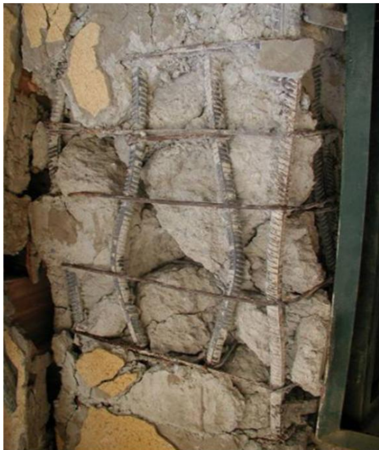
Figure I-13 : Flambement des barres et rupture par cisaillement (Séisme boumerdes Algérie 2003) [1].
