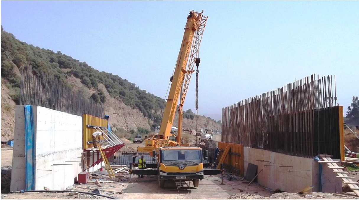
Bassin de dissipation d'énergie - vidange de fond-
