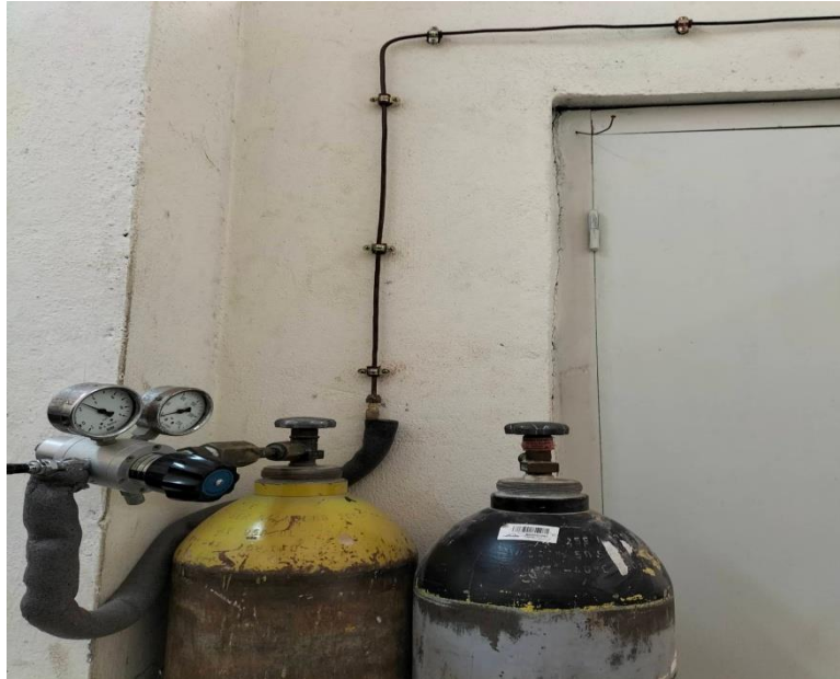
Figure II.2.3a : branchement de tuyau du gaz
