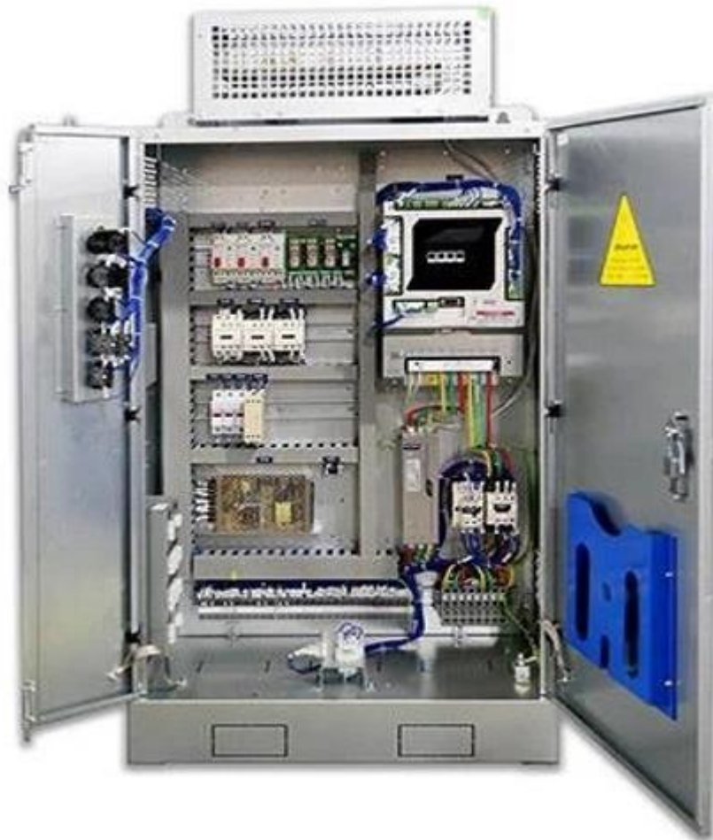
Figure I.35: Armoire de commande.
