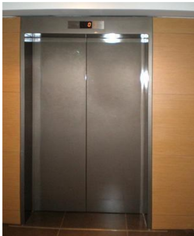
Figure I.32: Porte automatique (glissantes).
