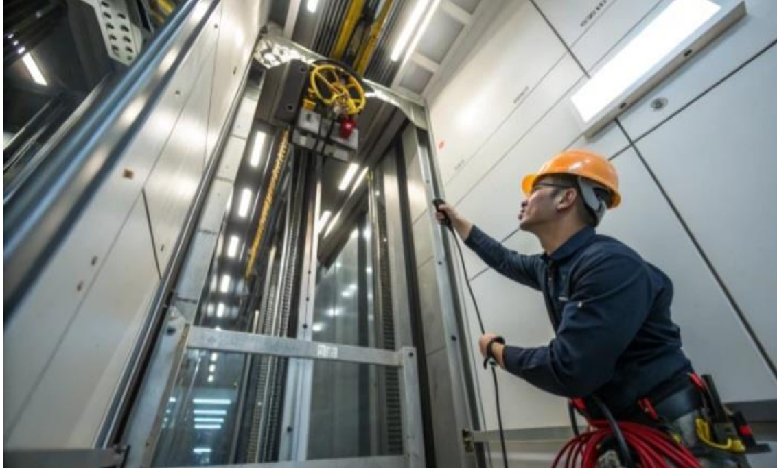
Figure IV.5 : Mesure de la tension des câbles dans le cadre d'une maintenance conditionnelle.
