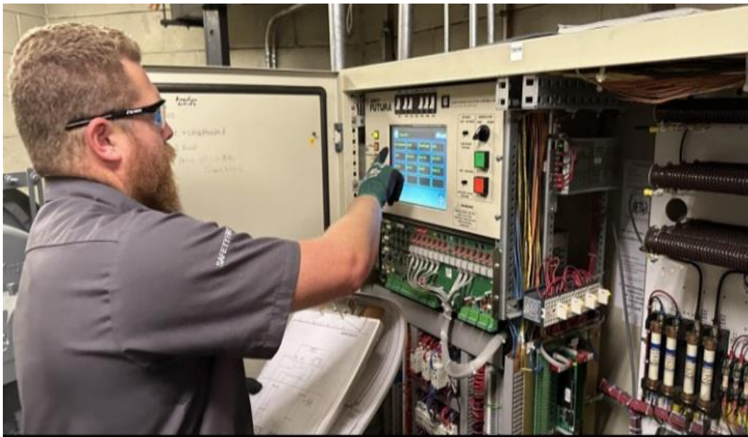
Figure IV.6: Exemple de suivi administratif : consignation des opérations dans le carnet d'entretien de l'ascenseur.
