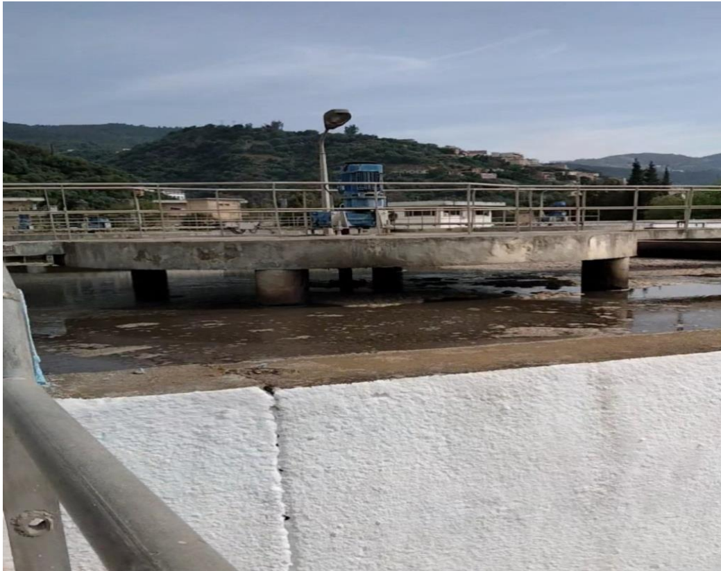
Figure 9 : Bassin biologique (aération).
