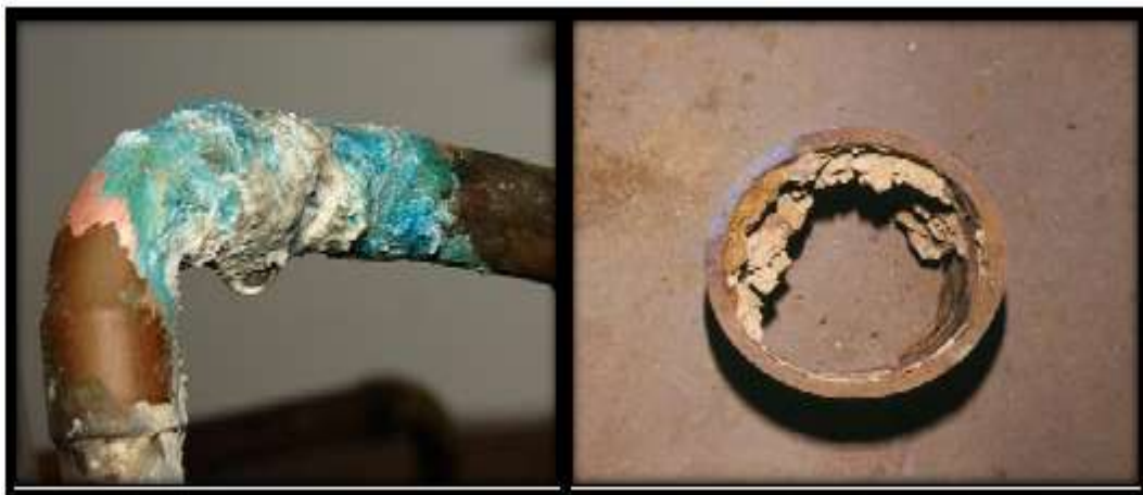
Figure 7.14 : la corrosion dans les conduites
