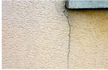
Fig. II. 5: Fissure de l'enduit. Source : Espace-façades.
