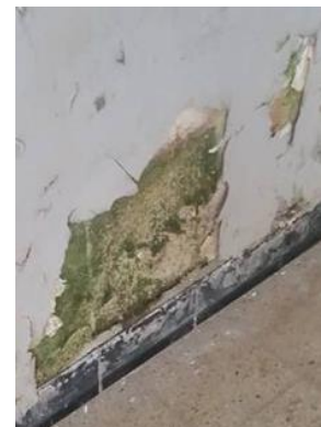
Fig. I. 78 : Moisissure des parois causée par humidité
