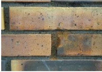
Fig. II. 4 : Dégradation des joints. Source : Weber.
