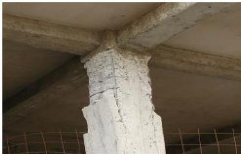
Figure I.12 : Décollement de l'enrobage
