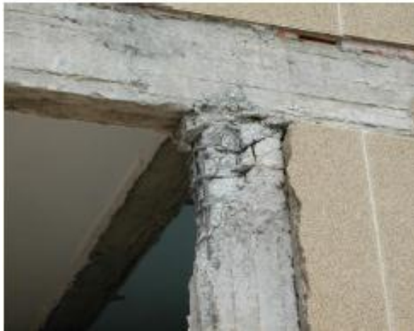
Figure I.6 : Rotule dans le poteau (Comportement à éviter)
