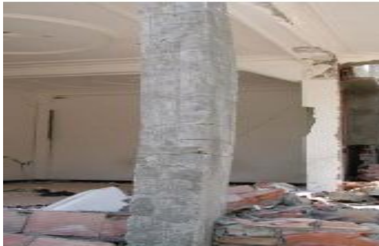
Figure I.10: Flambement de poteau.
