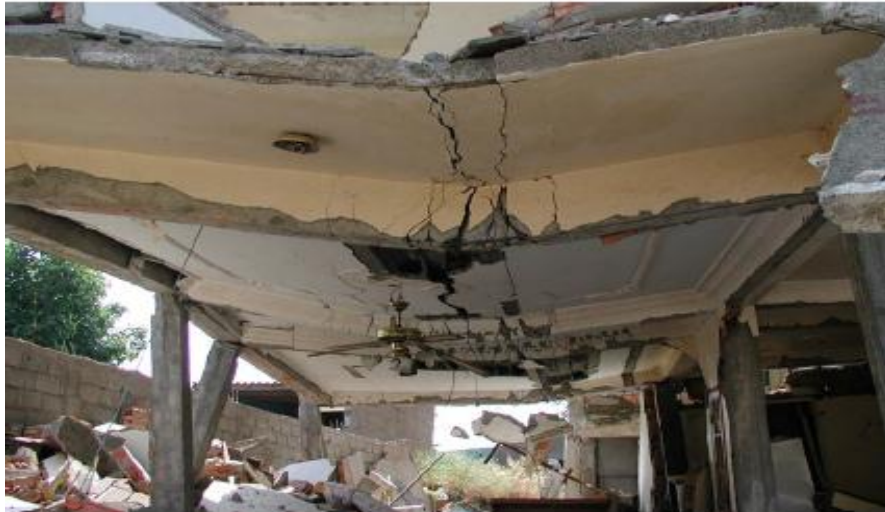
Figure I.11 : Rupture par flexion des poutres.
