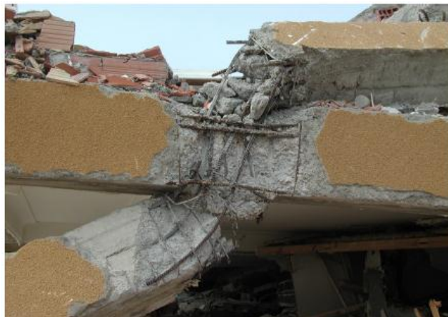
Figure I.5 : Rupture en zone nodale
