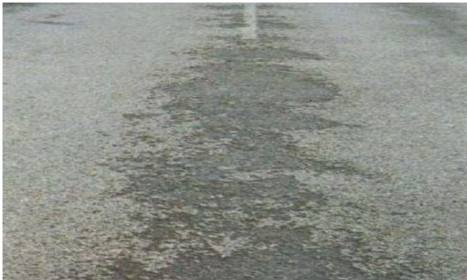
Figure I.7 : Dégradations d'arrachement (plumage). (LCPC,1998).
