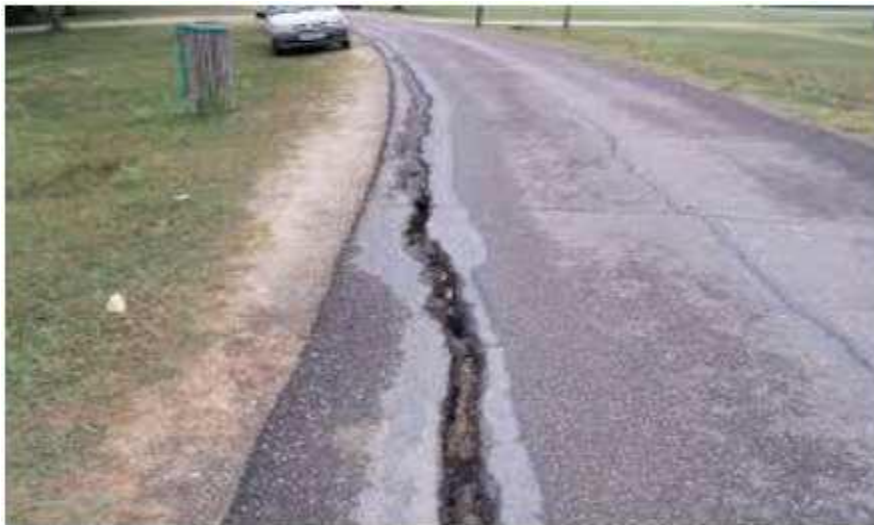
Figure I.10 : Fissures dans une chaussée.(LCPC,1998)
