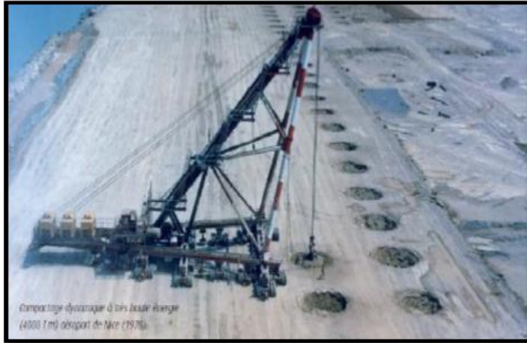
Figure III.4. Densification d'un terrain par compactage dynamique (cas réel de l'aéroport de Nice, 1978)
