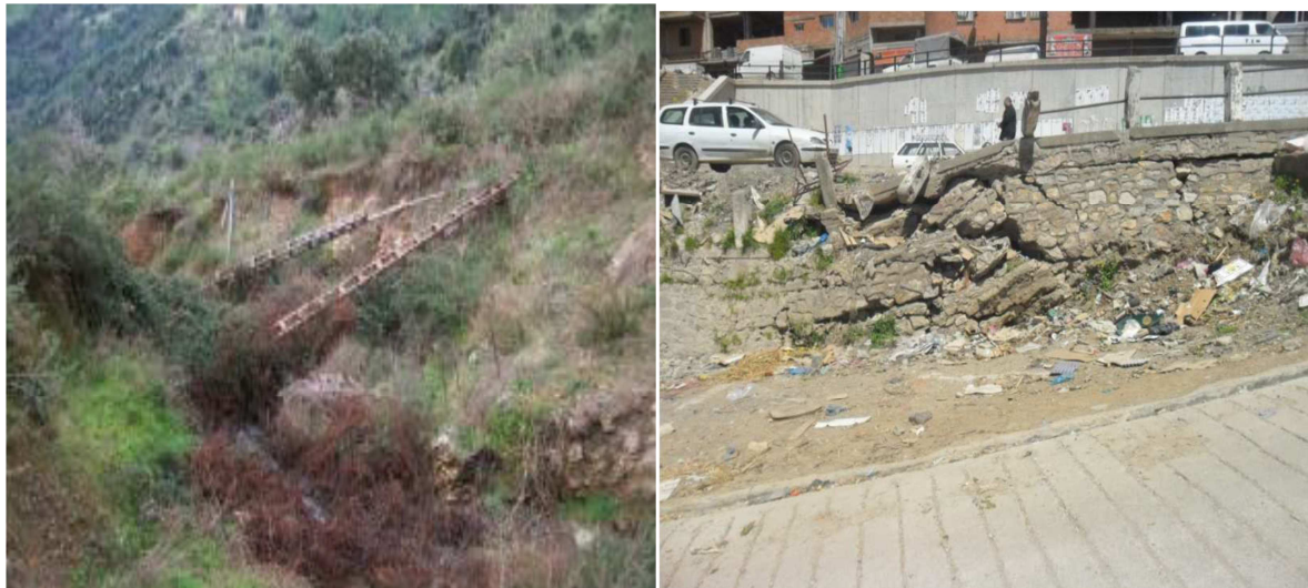
Figure IV.6. Glissement de terrain au niveau de la région de Ain El Hammam
