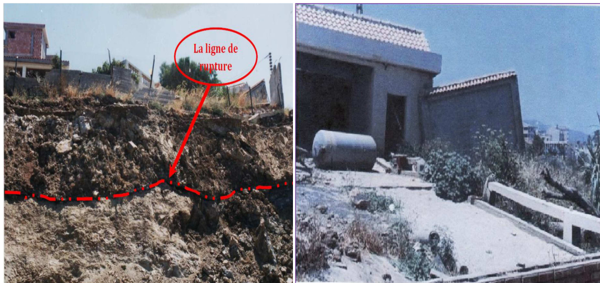
Figure IV.4. Glissement de terrain au niveau de la région de Tizirt
