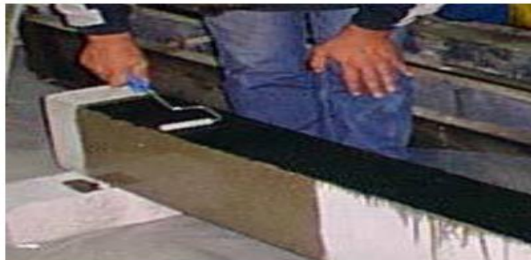
5. Mise en place sans étirement du tissu sur le support en béton
