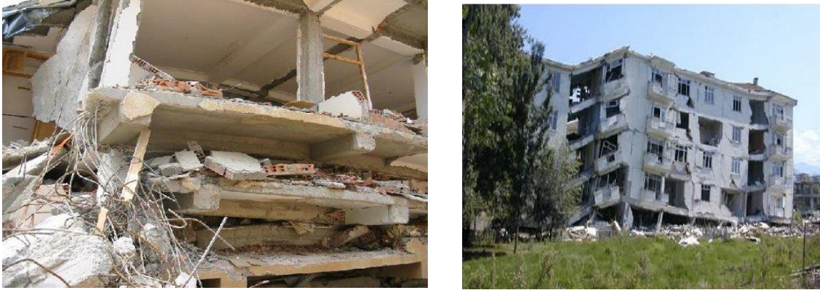
Figure II.3 : Effondrement partiel d'un bâtiment faute de mauvaise conception (séisme Boumerdes 2003) [30]
