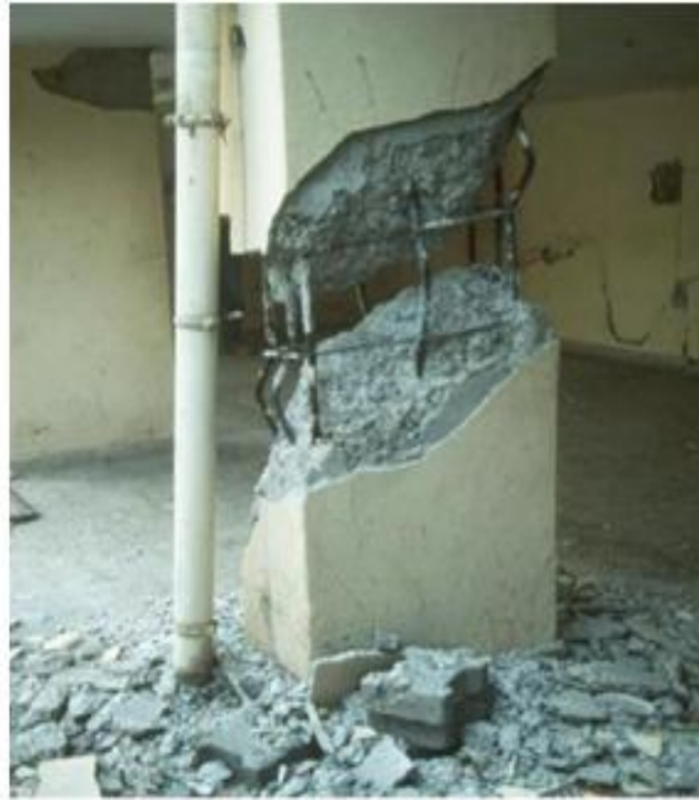
Figure II.6 : Rupture par flambement de poteaux [38].
