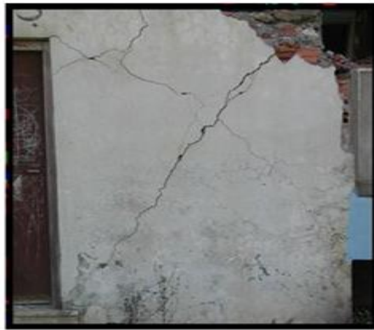
Figure II.4 : Fissures en «X», dislocation de la section, Rupture par écrasement du béton du au remplissage partiel [37]
