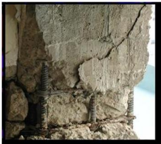
Figure II.5 : Éclatement du béton d'enrobage au niveau des zones nodales [37].
