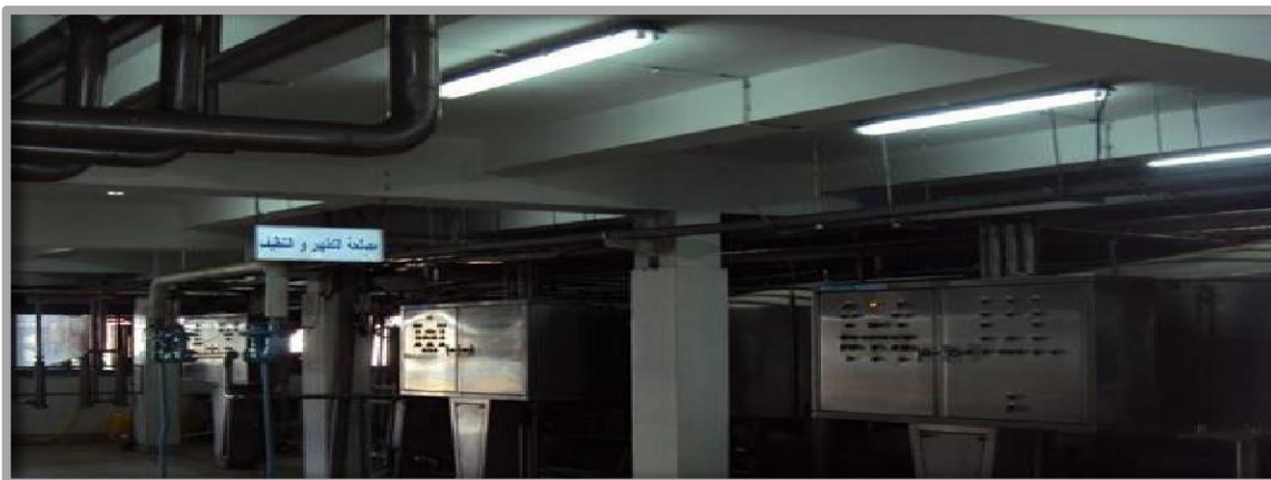
Figure N°07 :Installation automate de nettoyage en place CIP
