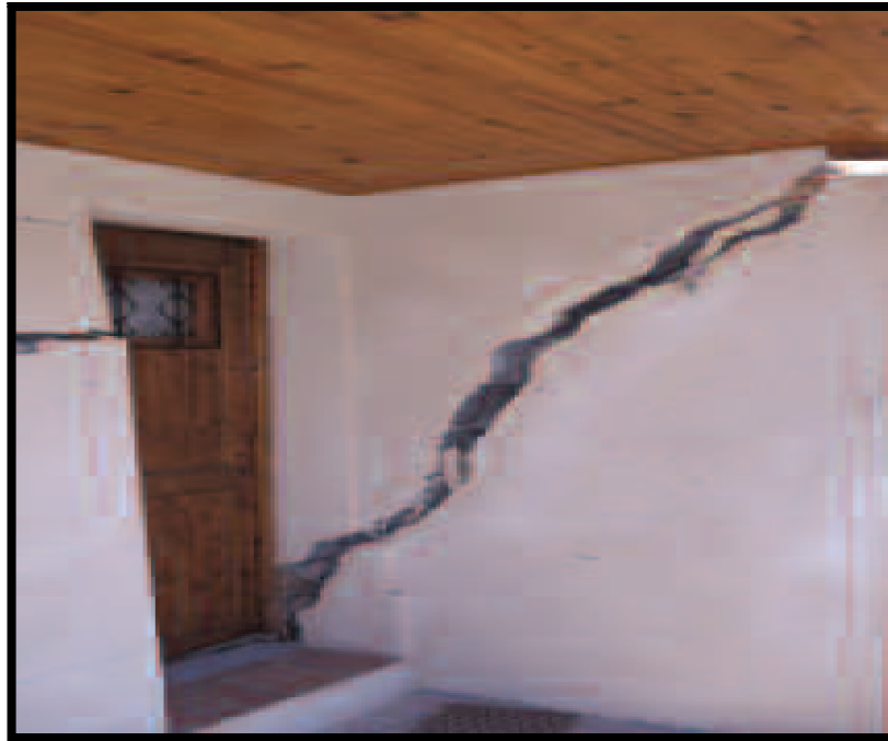
Fig. I.22 : Fissuration d'un mur
