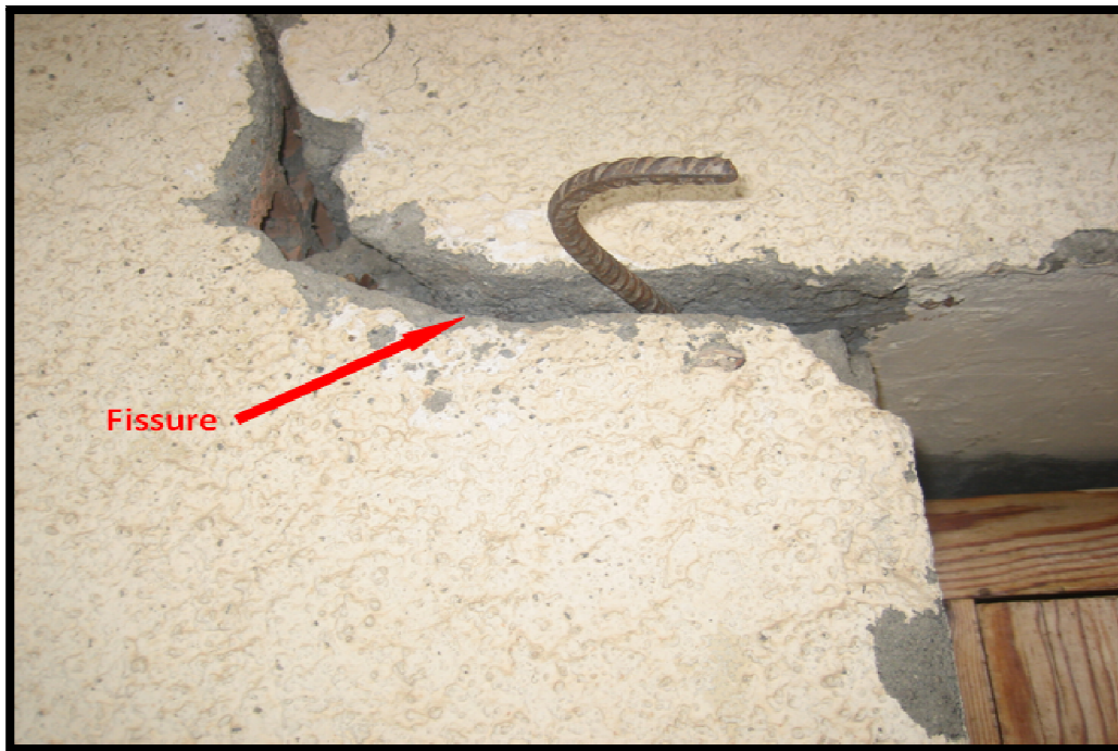
Fig. III.32: Fissurations au niveau des ouvertures
