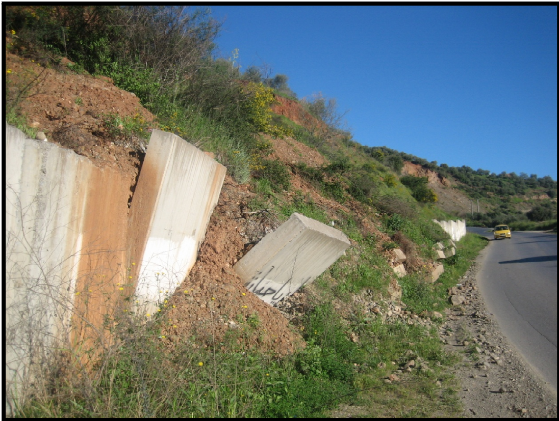
Fig. I.5: Glissement de terrain (RN 30 – Tabarkoukth)
