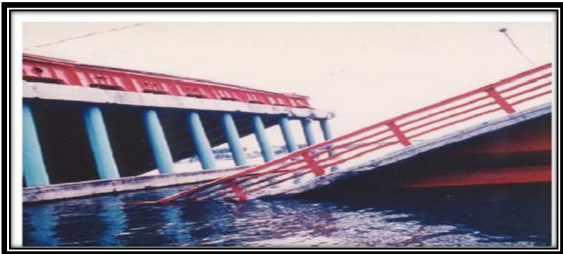
Figure III. 10: effondrement de pont de Showa par liquéfaction de sol (Séisme de Niigata 1964)
