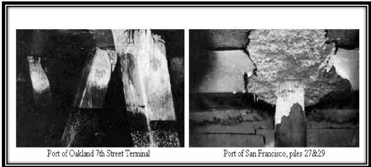
Figure III.11 : Dommages de pieux inclinés au niveau de la connexion avec leur chevêtre (Séisme de Loma Prieta 1989).
