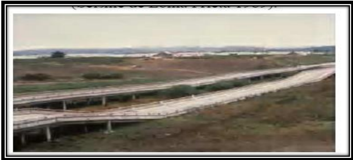
Figure III.12 : Effondrement du pont de Struve Slough de Wastonville et les dommages subis par ses fondations, (Séisme de Loma Prieta 1989).
