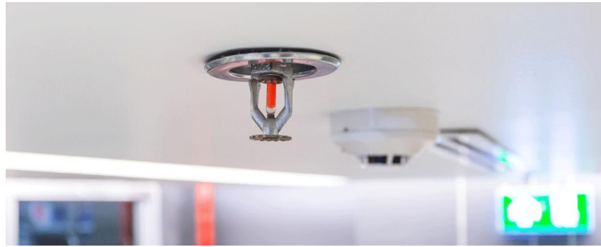
Figure 111: équipement de détections automatique du feu
