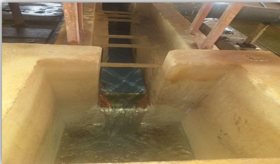
Figure 35 : Canal final de la station de neutralisation de l'ENIEM (Originelle, 2022)
