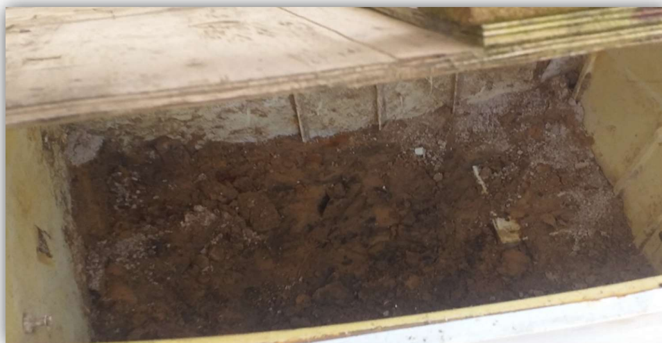
Figure 30 : Sols souilles de substance dangereuse (Originelle, 2022)
