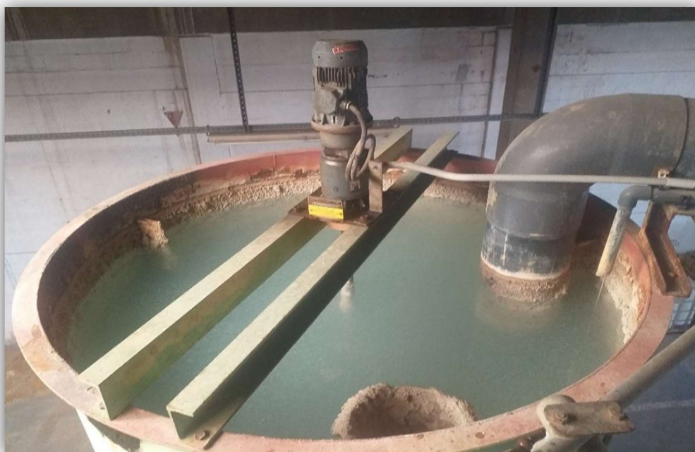
Figure 60 : Bassin de floculation (Originelle, 2022)
