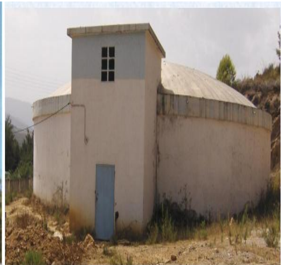
Figure 4.2 : Réservoir posé au sol
