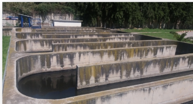
Figure 14 : Bassin de désinfection (ONA. Boumerdès, 2016).
