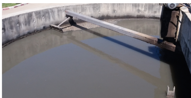
Figure 11 : Dessableur - dégraisseur (ONA. Boumerdès, 2016)
