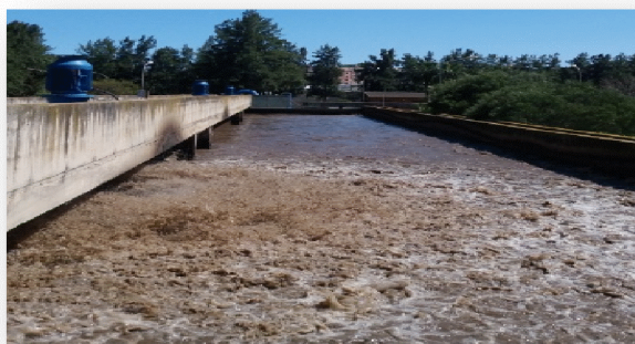
Figure 12 : Bassin d'aération en état de marche (ONA. Boumerdès, 2016)
