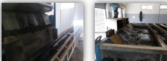
Figure 16 : Filtre à bande (super-presse), (ONA. Boumerdès, 2016).
