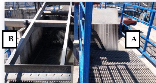
Figure 10 : Dégrilleur mécanique (B) et manuel (A), (ONA Boumerdès, 2016).
