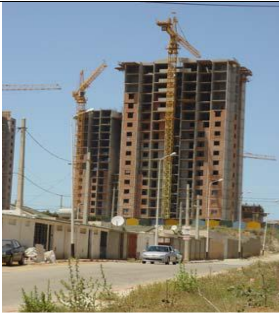
Fig.I.6 : Bâtiment en cours de construction avec voiles en béton armé, très bonne résistance à l'action sismique [2].
