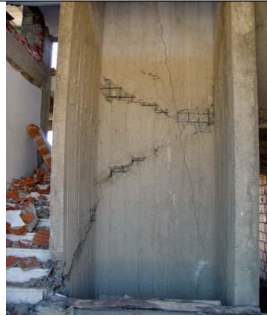
Fig.I.11 : La présence des voiles en béton armé au droit de la cage d'ascenseur a certainement sauvé le bâtiment (fig.I.10) de l'effondrement
