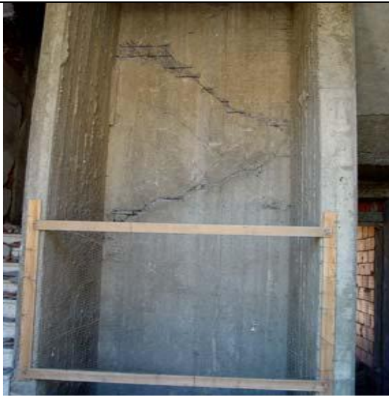
Fig.I.12 : La présence des voiles en béton armé au droit de la cage d'ascenseur a certainement sauvé le bâtiment (Fig.10) de l'effondrement
