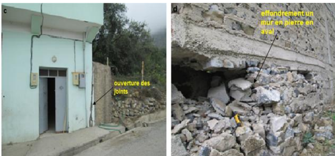
Figure 3.25 : Vues des dégâts au site étudié village Echetal commune Ait Smail (suite).
