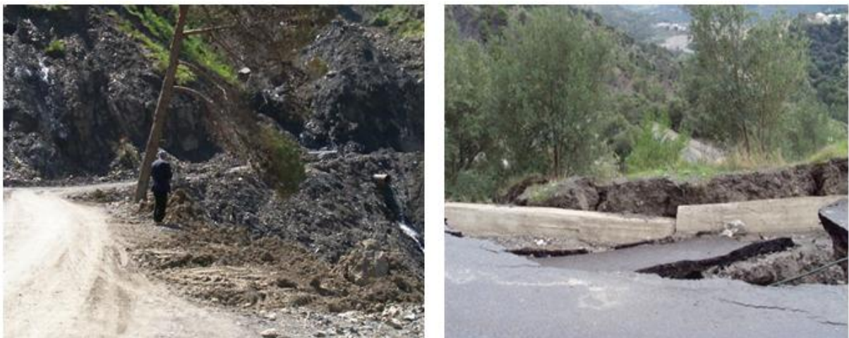
Figure 3.6 : Village Ouled Ali menacée par le glissement de terrain (AGC, 2012).
