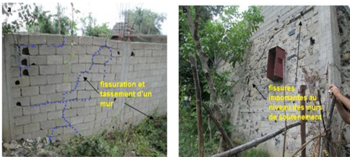
Figure 3.24 : Vues des dégâts au site étudié village Echetal commune Ait Smail.
