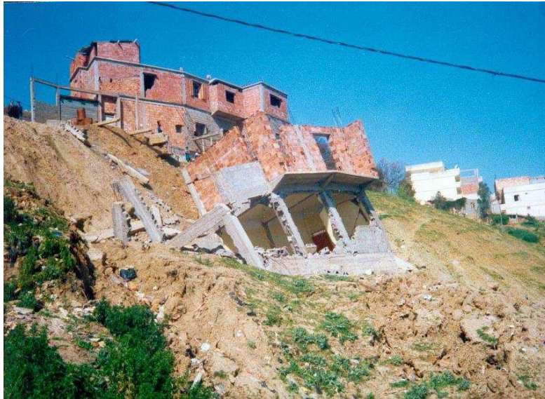
Figure 3.20 : Glissement de Tizi quartier de Bejaia. Basculement d'une habitation (Bendadouche et al., 2008).
