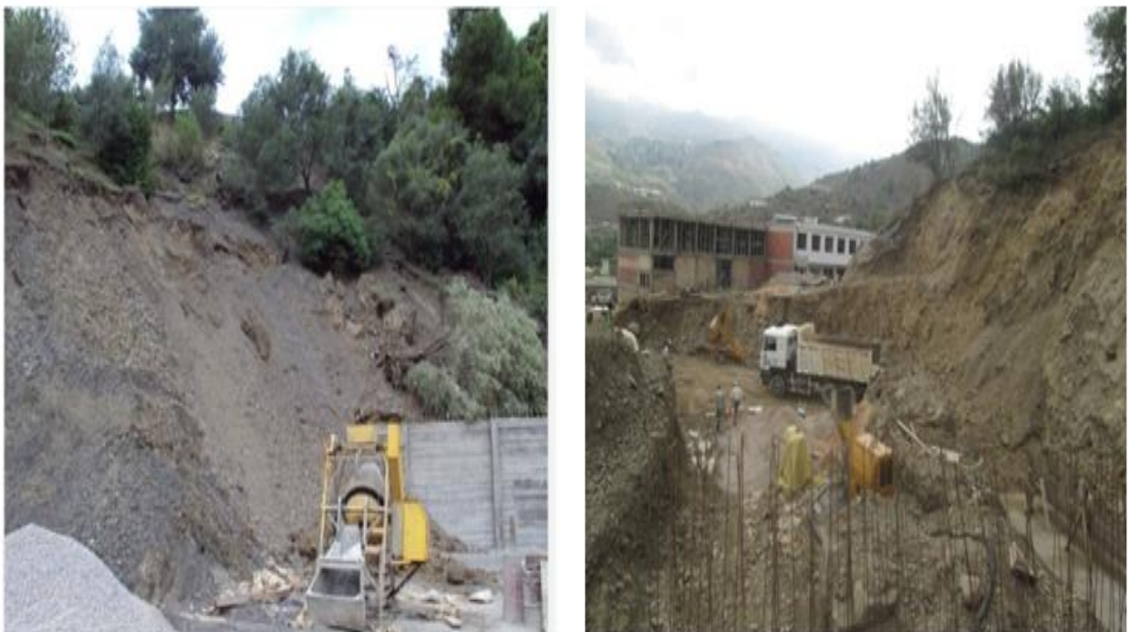
Figure 3.30 : Glissement de terrain a cause des travaux au village Echetel.
