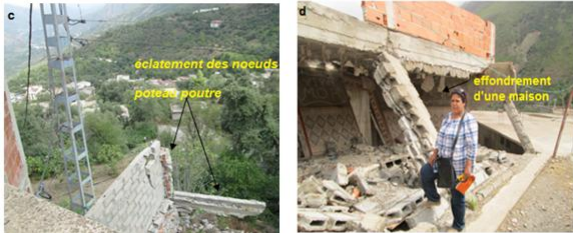
Figure 3.23 : Vues des dégâts au site étudié village Ouled Ali commune Teskriou (suite).
