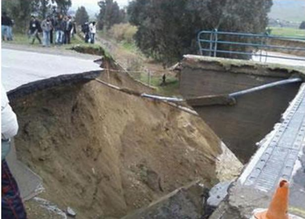
Figure 3.21 : Glissement spectaculaire d'un pont qui relie les deux communes Ait Smail et Ouled.
