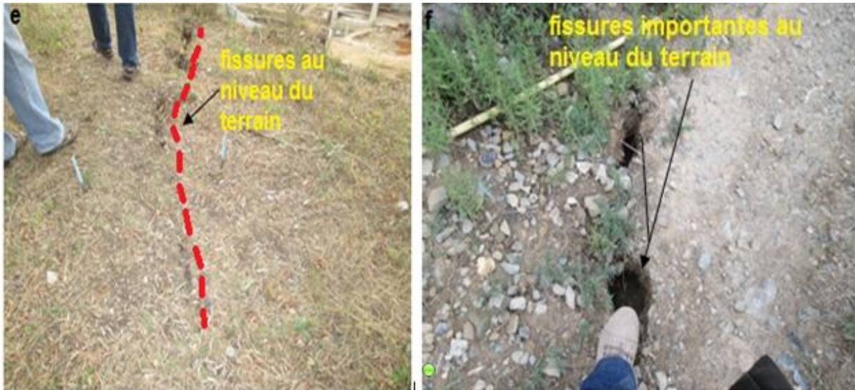
Figure 3.26 : Vues des dégâts au site étudié village Echetal commune Ait Smail (suite).
