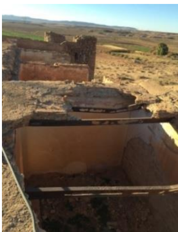
Figure IV-67 : Photo montrant l'effondrement ou niveau de la toiture des écuries. Source : Auteur
