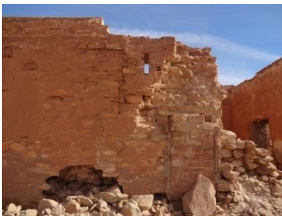
Figure IV-63 : photos montrant l'état des Parois. Source : Auteur
