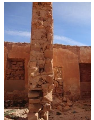
Figure IV-65 : photos montrant l'état d'un mur. Source : Auteur
