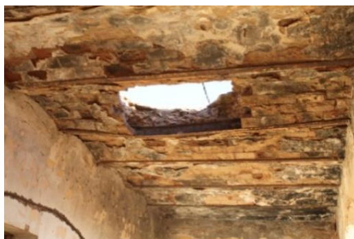
Figure IV-64: photos montrant l'état de la toiture. Source : Auteur
