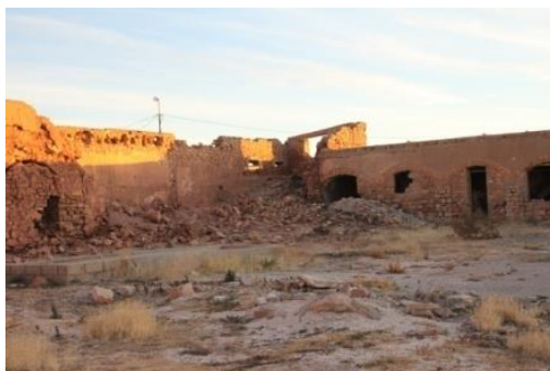
Figure IV-68 : Photo montrant l'effondrement au niveau d'une tour de garde. Source : Auteur
