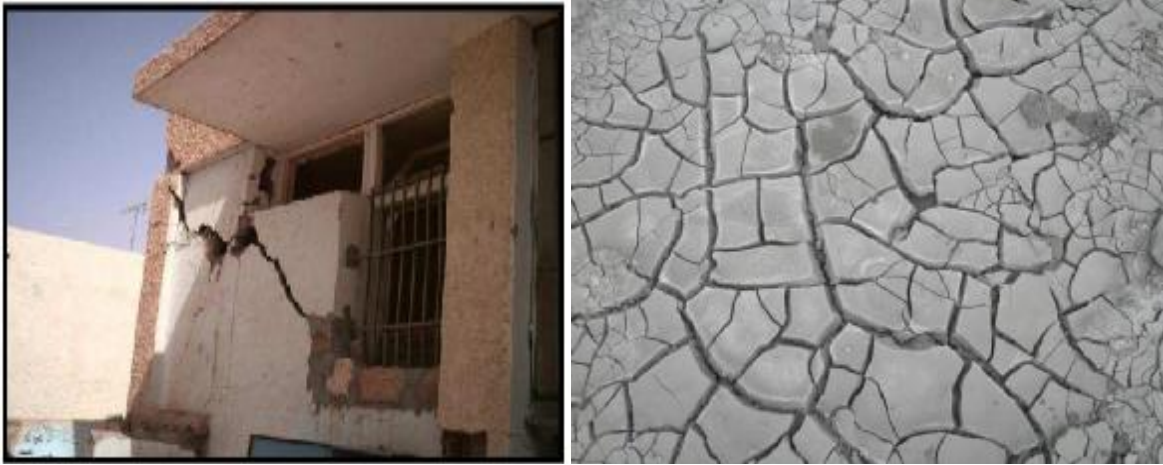
Figure I.10 : Désordres dues aux retrait-gonflement des sols.
