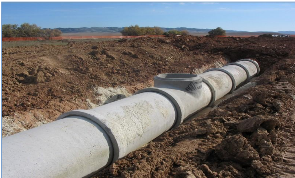
Figure (IV.1) : photo d'une conduite d'assainissement avec regard en béton
