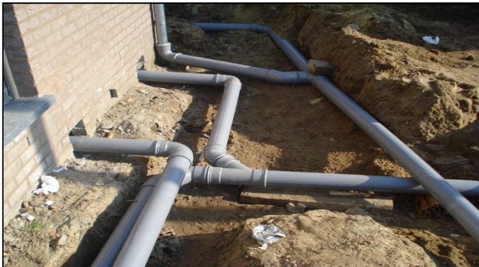
Figure (IV.2) : photo d'un réseau d'assainissement PVC
