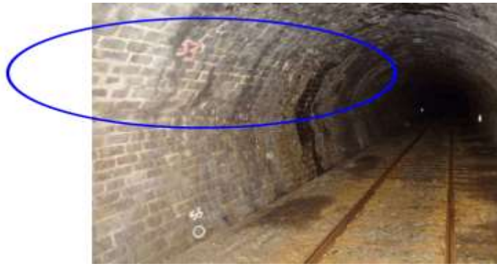
Figure II.3 : Irrégularité en forme de Bombement
