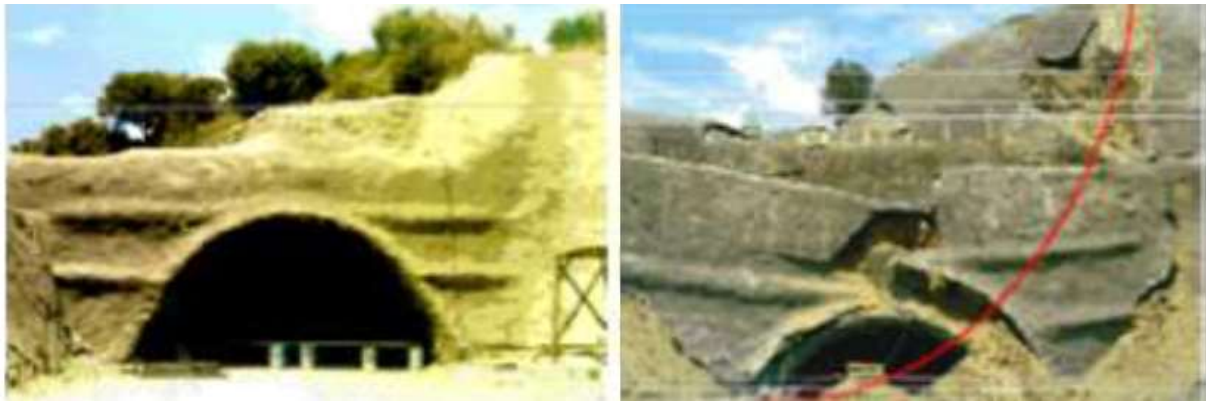
Figure II.2. Tunnel de Patra avant et après l'effondrement en Grèce, 1998 (Patra., 2004)
