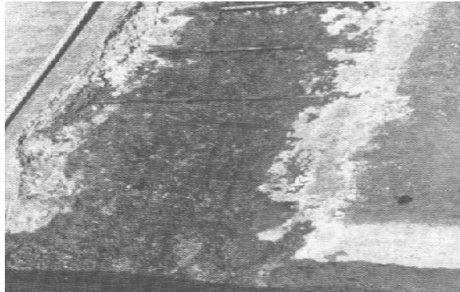
Figure II.10 : Béton détérioré par une attaque par les sulfates - Barrage Fort Peck sur la rivière Missouri au Montana [22]
