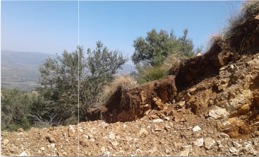
Figure 31. Photo qui montre une destruction de la partie superficielle du sol
