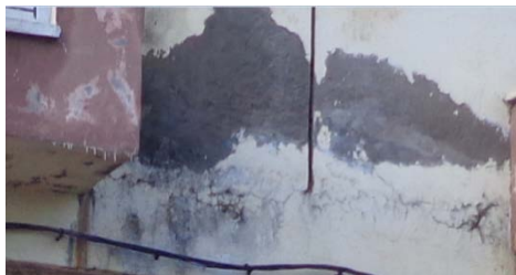
Figure IV-51 : Fissuration dans les murs Source : auteur
