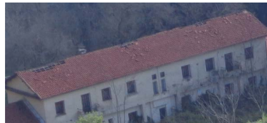
Figure IV-52: Détachement des tuiles Source : auteur
