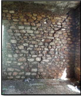
Figure IV-48: image montrant la fissuration du mur ; source : Auteur
