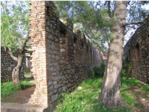
Figure IV-56 : les arbres forment des allées à l'intérieur des blocs ou les cloisons intérieures sont disparues
