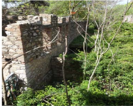
Figure IV-57: la végétation couvre les ruines et ferme l'accès vers le sous sol
