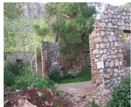
Figure IV-47 : vue sur les arrêtes endommagés Source : auteur
