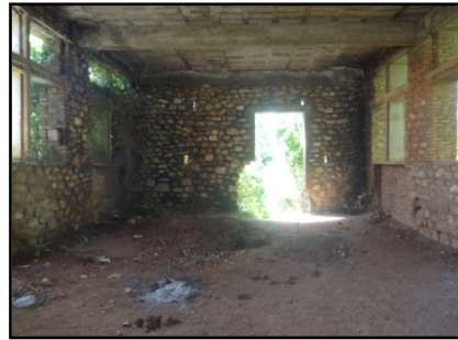
Figure IV-49 : Déchaussement des pierres des murs porteurs Source : auteur
