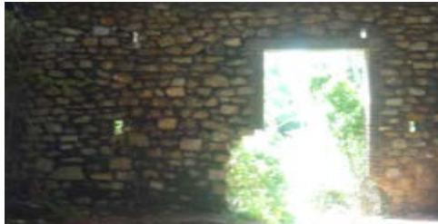
Figure IV- : La détérioration des murs du pénitencier
