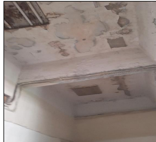
Figure 59: photo de l'état dégradé à l'intérieur du bâtiment de l'ancienne gare, source : auteurs
