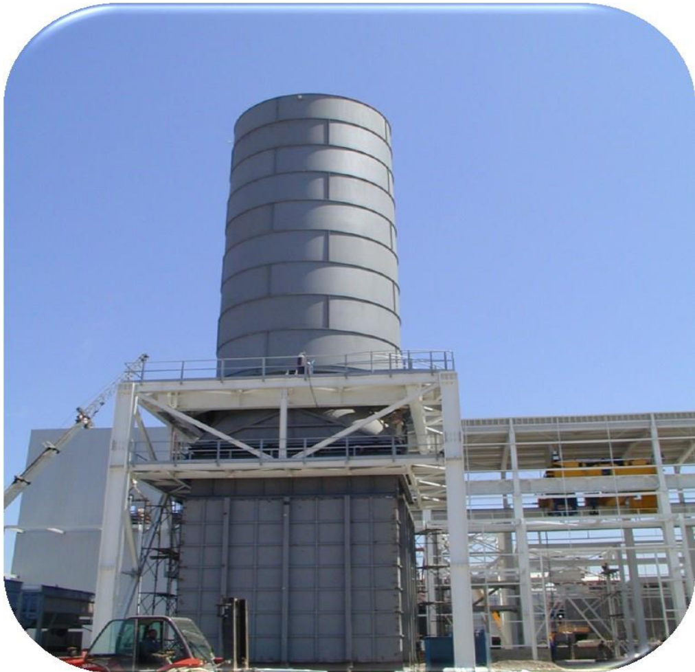
Figure 40 : système d'échappement (diffuseur + cheminée).
