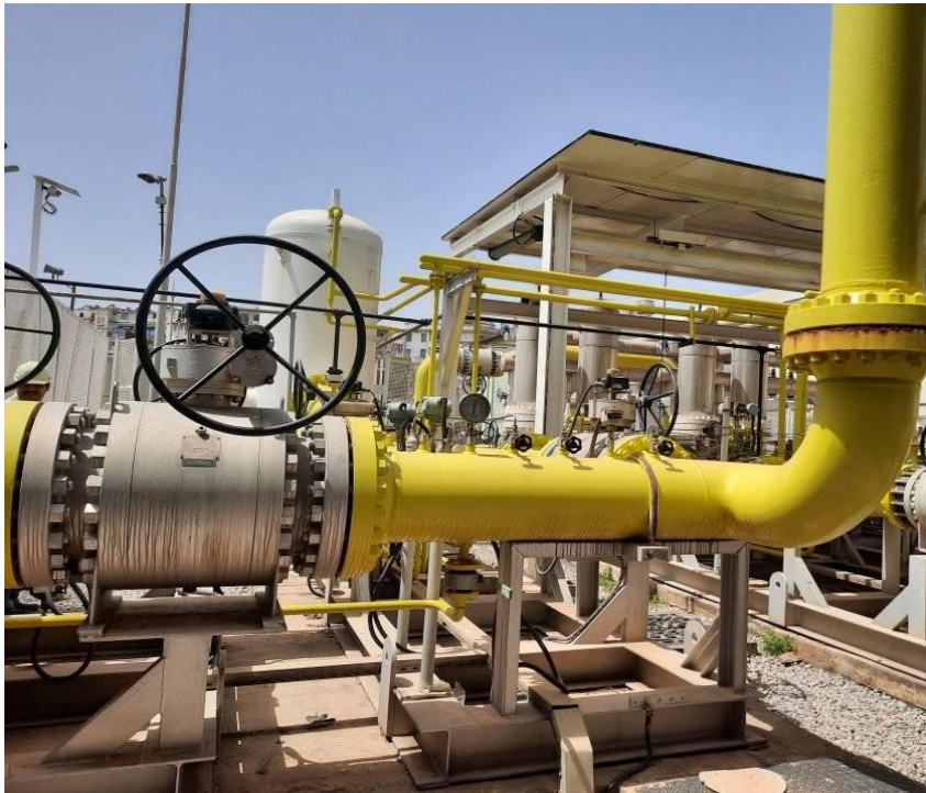
Figure38 : Positionnement du poste gaz de la centrale du Hamma II.
