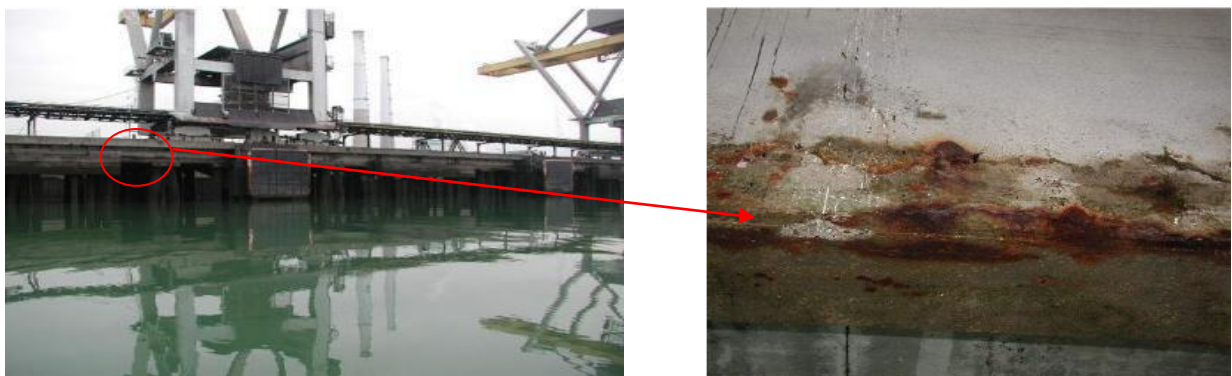
Figure 1.12: Poutre située en bord de mer [38]
