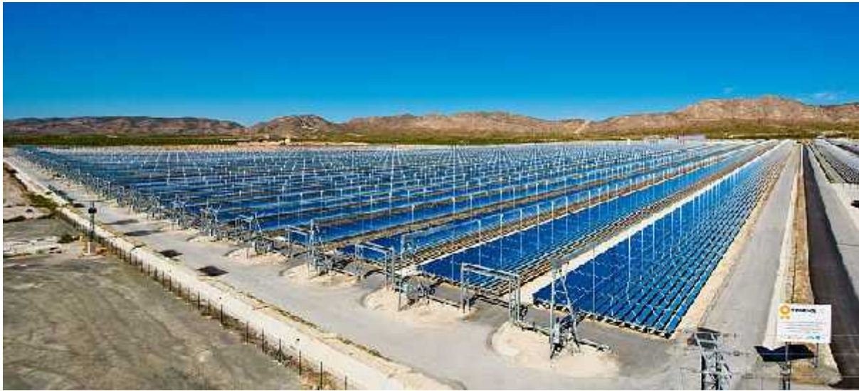
Figure 14 : Centrale solaire Fresnel
