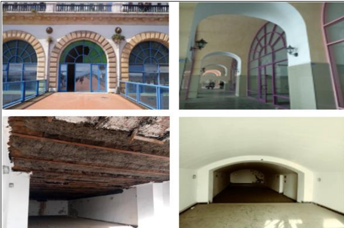
Figure 111 : Etat actuel des voûtes de l'impératrice. Source : Auteurs.
