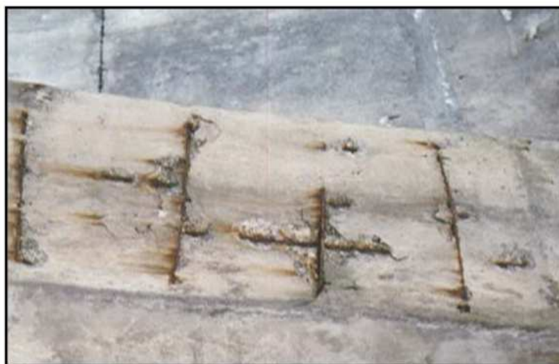
b- Corrosion des armatures.
