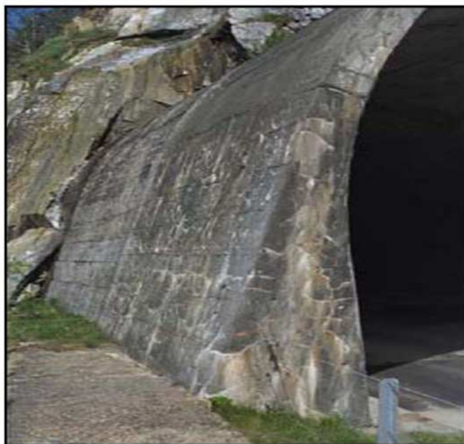
Figure 2.1: fissurations grossières dues à l'alcali – réaction (Entrée d'un tunnel) [84].
