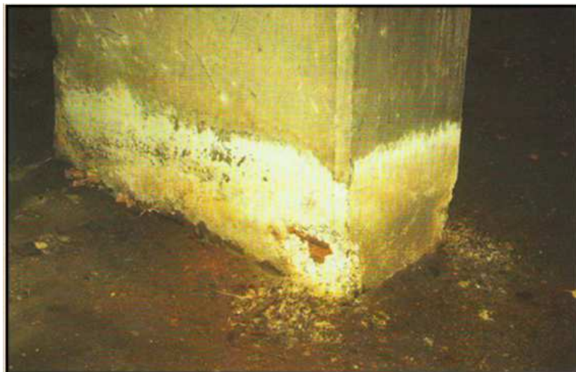
Figure 2.8 : Dégradation du béton par réaction sulfatique en pied de poteau [108].
