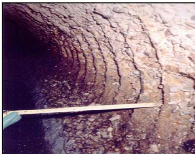
Figure 2.19 : Dégradation par corrosion du béton dans un réseau d'assainissement [ ].
