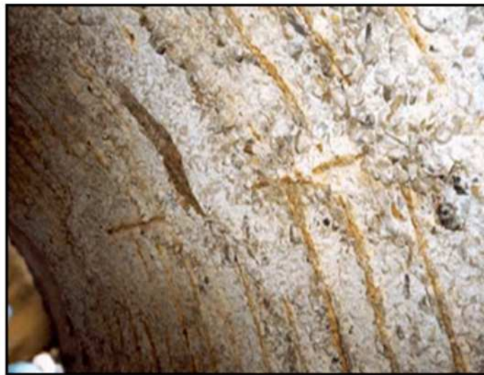
Figure 2.18: Formation de gypse (couleur blanche) à l'intérieur de la conduite d'assainissement [ ].
