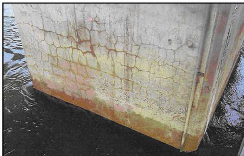
Figure 2.14 : réseau de fissures dans une pile de pont en contact avec l'eau, endommagée par formation différée d'ettringite [113].
