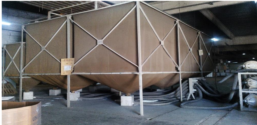
Figure II.16. Le stockage du polystyrène dans les silos à l'ENIEM.
