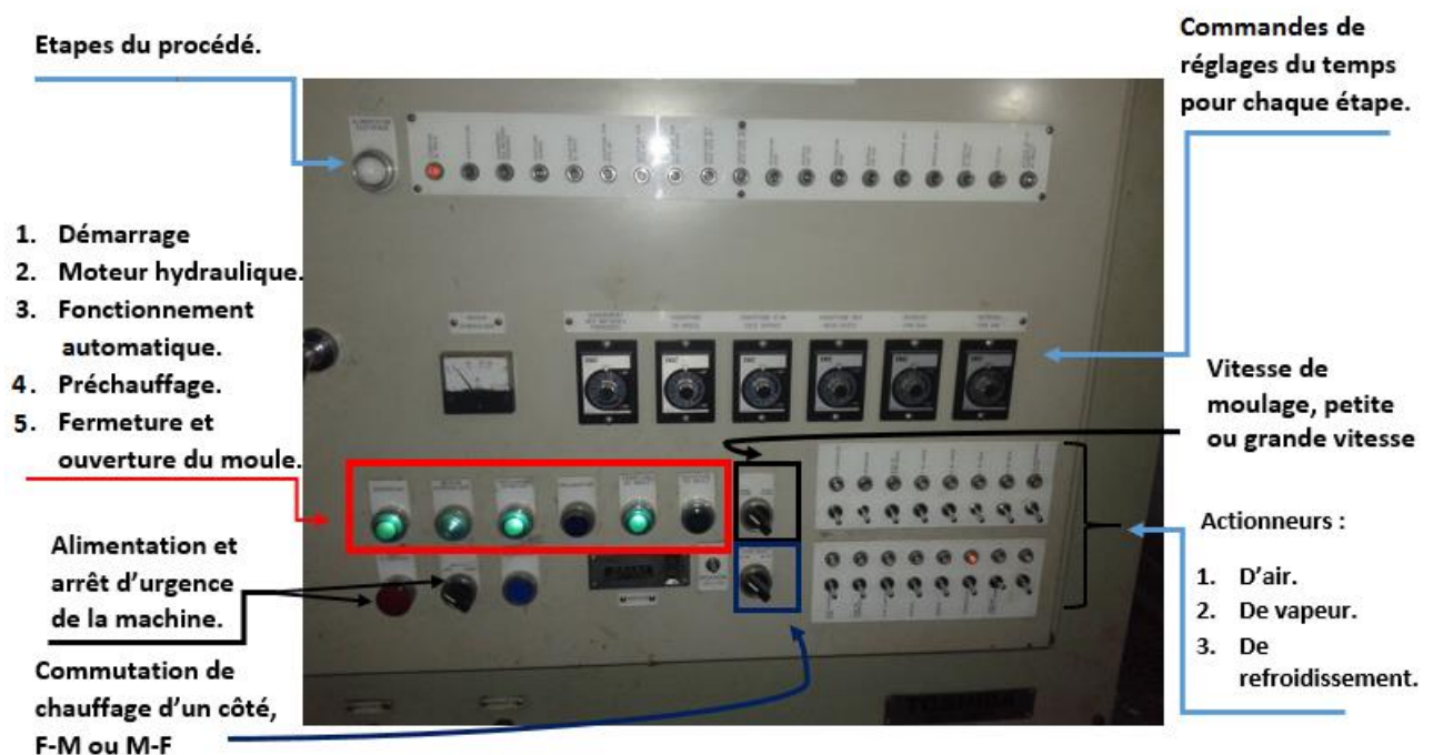
Figure III.5. Tableau de commande de la machine ACE 25 AR de l'ENIEM.
