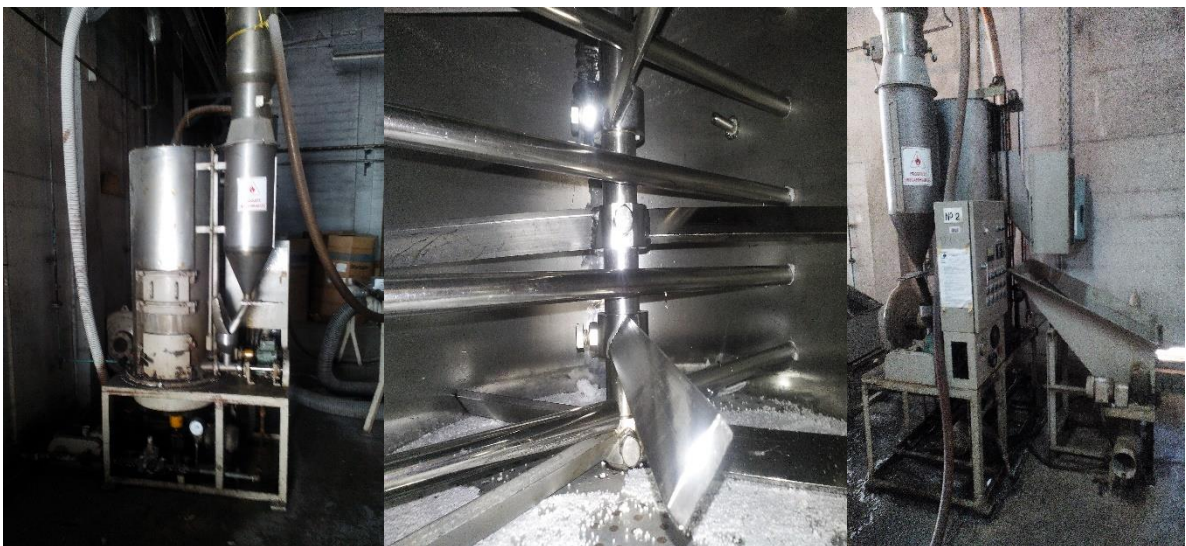
Figure II.13.2. . Préexpandeur à fonctionnement continue utilisé à l'ENIEM.
